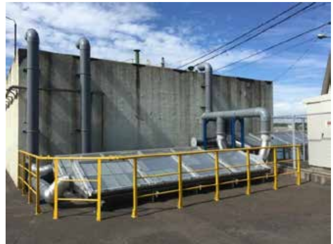
図1 し尿受入施設脱臭装置外観
